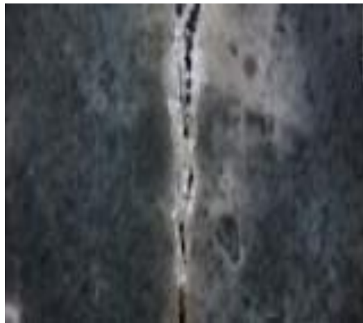
Рис. 2. Трещина в бетоне до начала работы бактерий.
