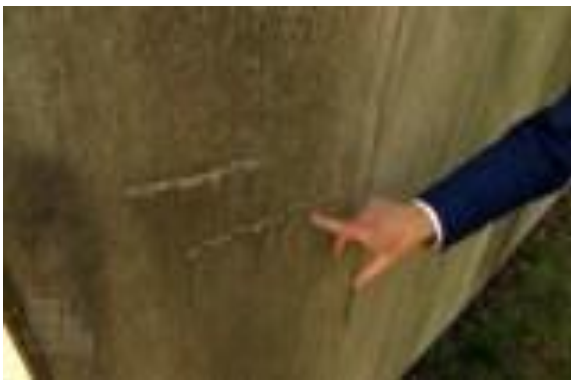
Рис. 5 Результат залечивания трещин.
