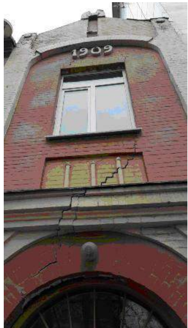
Рисунок 11. Фотография развития деформаций от нового здания 2017 г.
