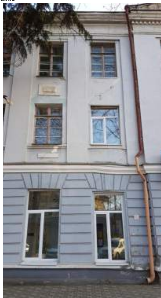
Рисунок 8. Фасад исторического трёхэтажного здания с деформацией по всей высоте
