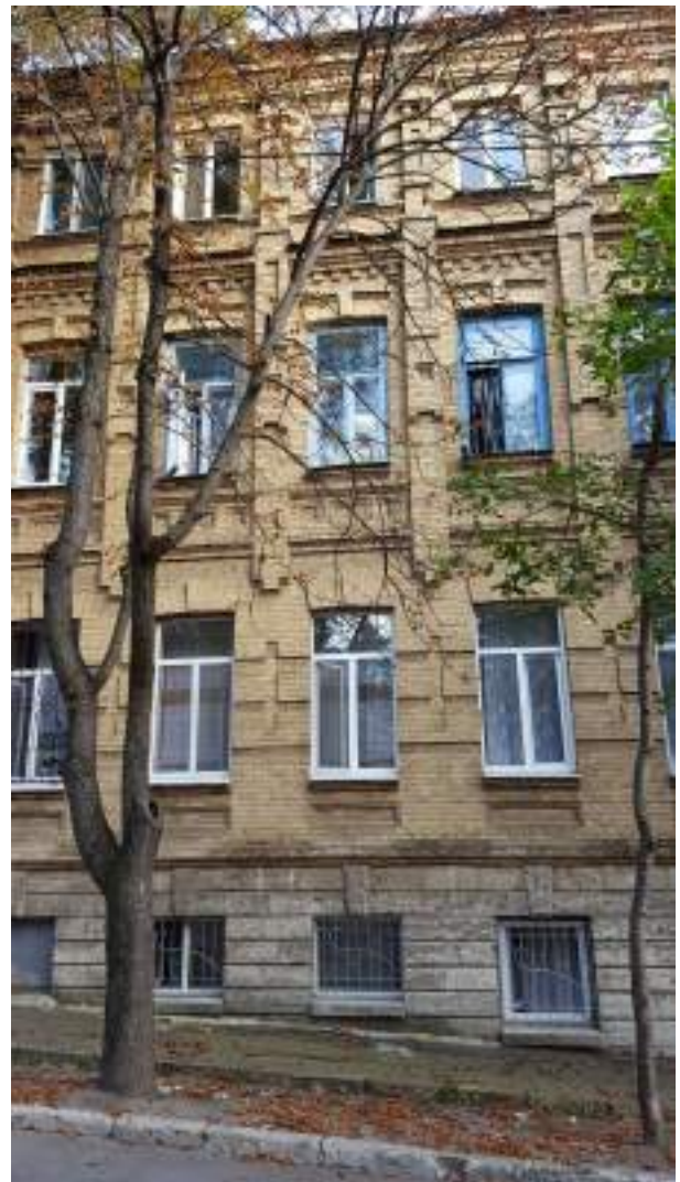
Рисунок 6. Четырёхэтажное здание в г. Пятигорске на участке с перепадом высот более 140мм.
